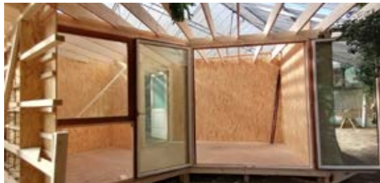
Die Sto-Stiftung unterstützt studentische Selbstbau-Projekte im Rahmen des „DesignBuild-Projekts“. Ein Ergebnis des Projekts ist das für obdachlose Menschen gedachte „Impulshaus“ der FH Kärnten, das sogar mit dem Menschenrechtspreis ausgezeichnet wurde. Foto: FH Kärnten
